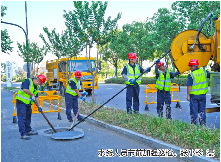
水务人员节前加强巡检。张小珍 摄
