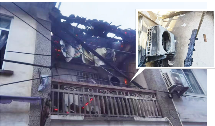
被烧的空调外机和外墙。消防供图
