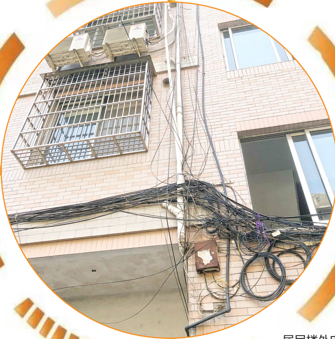
居民楼外电线乱拉。
