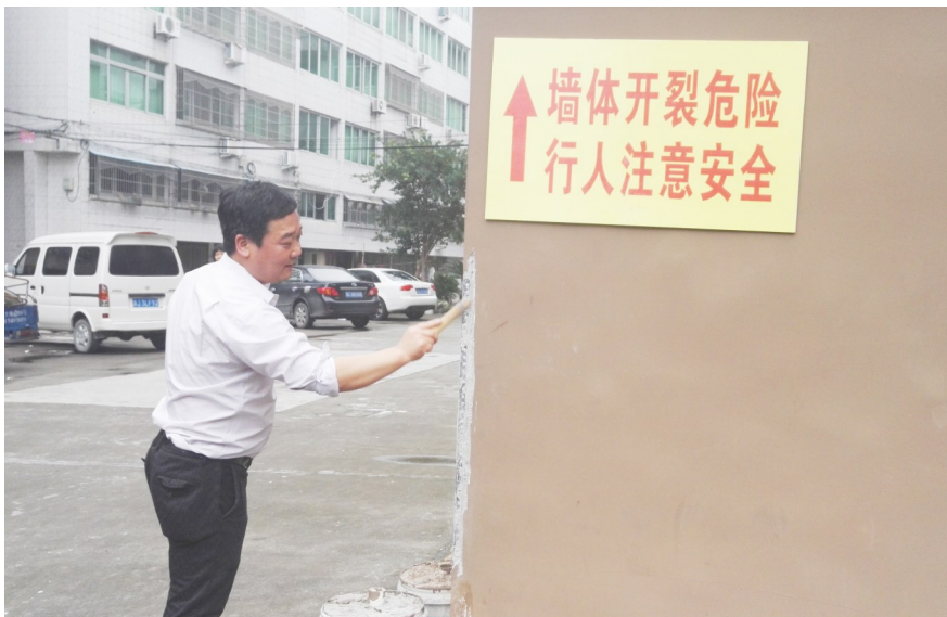
开裂的墙体存在安全隐患。记者 杨海虹 摄
