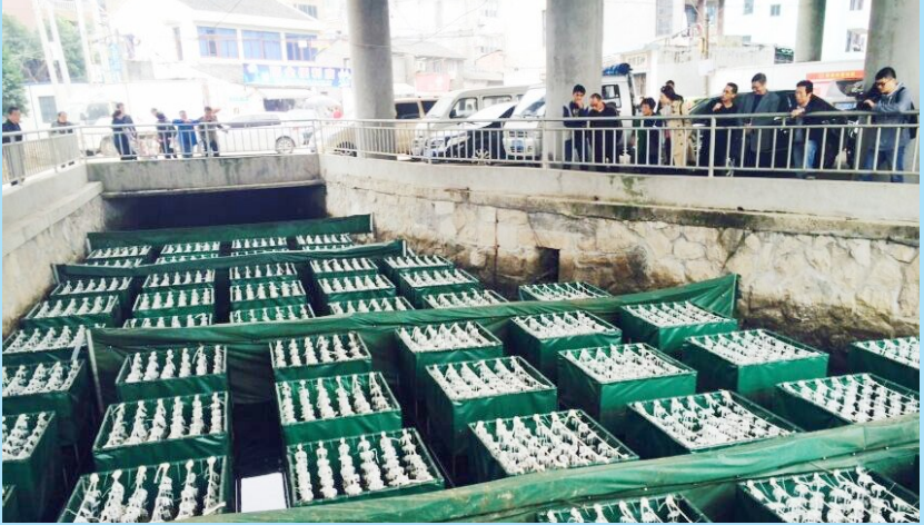
北城社区荷岙村在建的污水处理装置。记者 林伊格 摄
