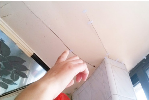
天花板上出现裂缝。 记者 程遥 摄
