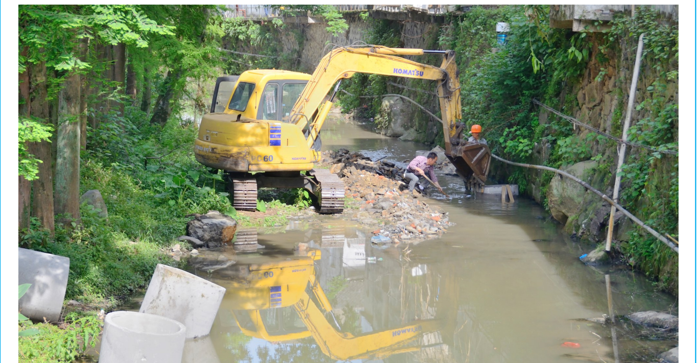
5月4日，乐清老城区截污纳管工程中的金仓路南侧排污管道的铺设开工。金仓路为沿溪道路，非常狭窄，现将水泥管铺在溪中，再将排污钢管铺设水泥管上。由于金溪上游北侧排污管道已基本铺就，南侧排污管道工程完工后，金溪上游有望实现溪水重清。图为施工人员在溪中挖掘铺设。 签约摄影师 黄一牙 摄
