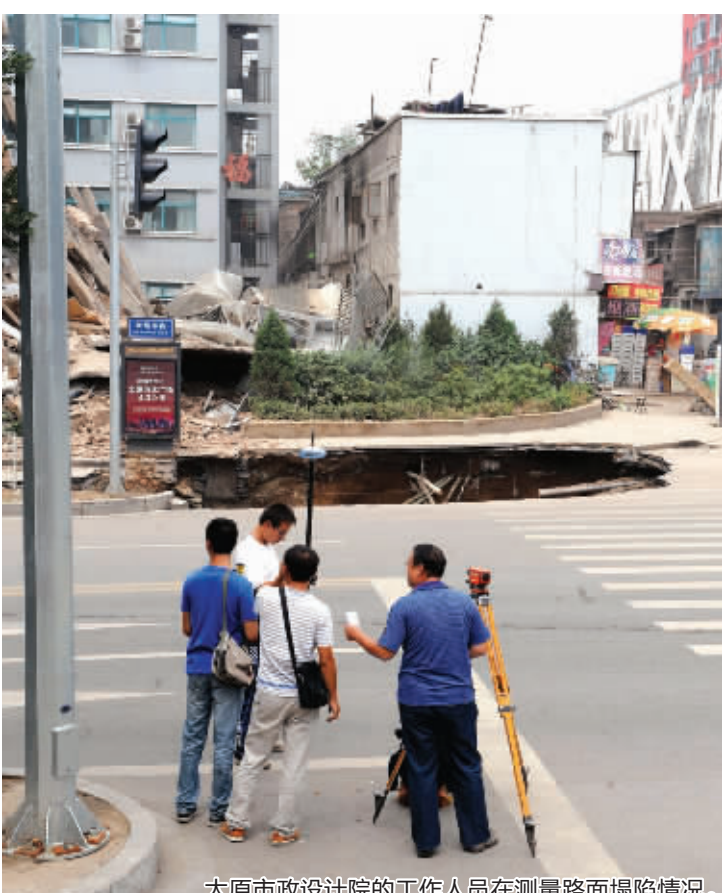
太原市政设计院的工作人员在测量路面塌陷情况。
